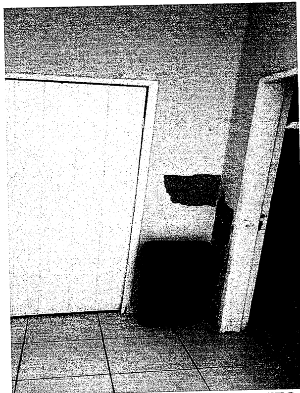
FIGURA 16: REBOCO COM DEFEITO
