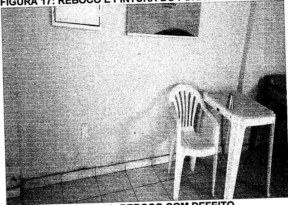
FIGURA 18: REBOCO COM DEFEITO
