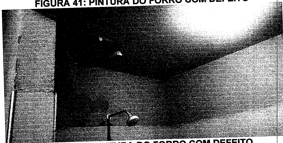
FIGURA 42: PINTURA DO FORRO COM DEFEITO
