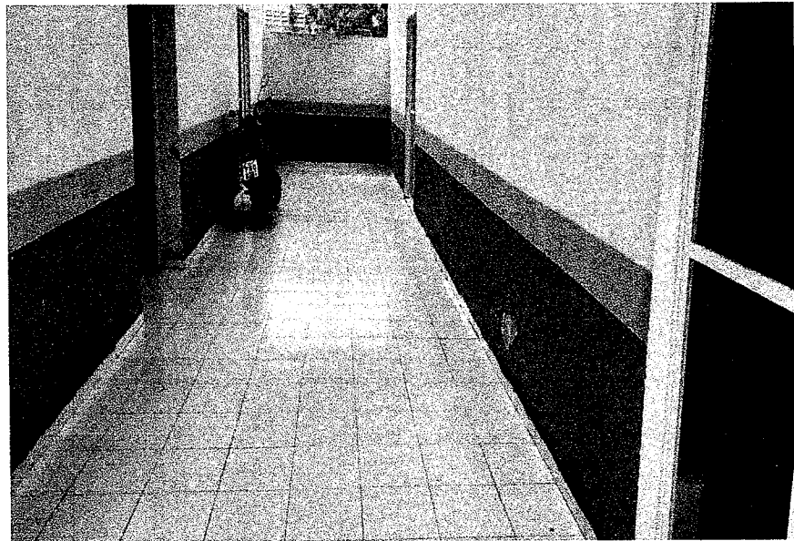
FIGURA 24: PINTURA COM DEFEITO
