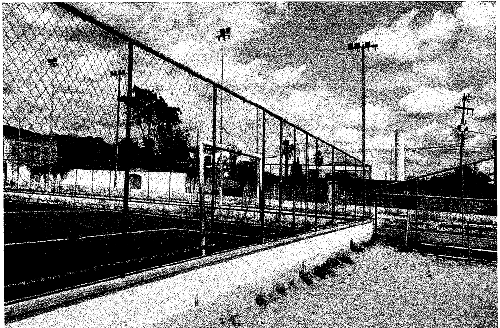
FIGURA 50: ALAMBRADO COM DEFEITO
