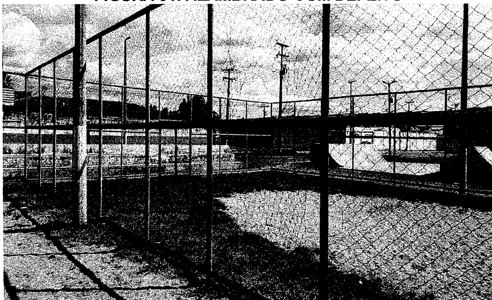
FIGURA 52: ALAMBRADO COM DEFEITO
