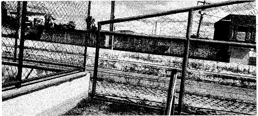
FIGURA 54: ALAMBRADO COM DEFEITO
