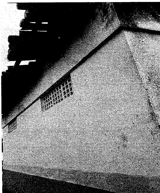
FIGURA 12: TELHADO COM DEFEITO
