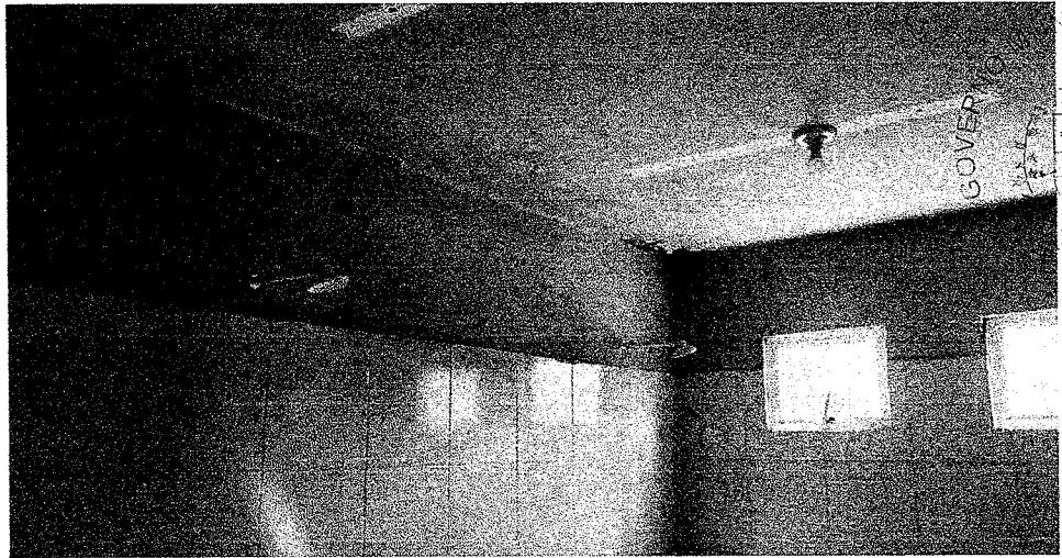
FIGURA 40: PINTURA DO FORRO COM DEFEITO
