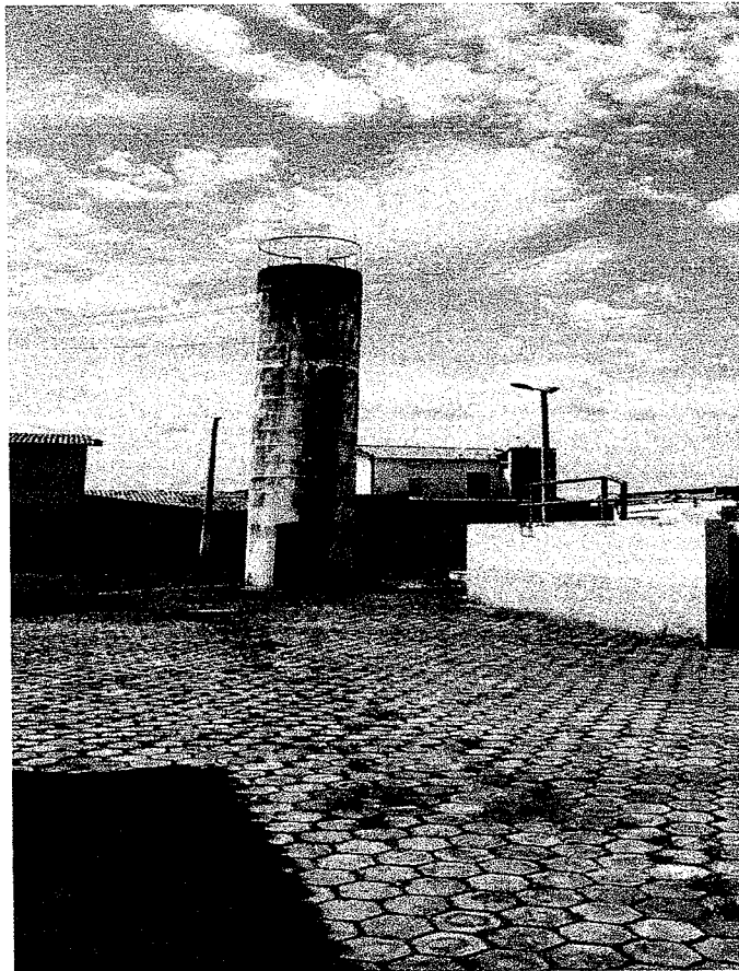
FIGURA 13: PINTURA CAIXA D'ÁGUA COM DEFEITO
