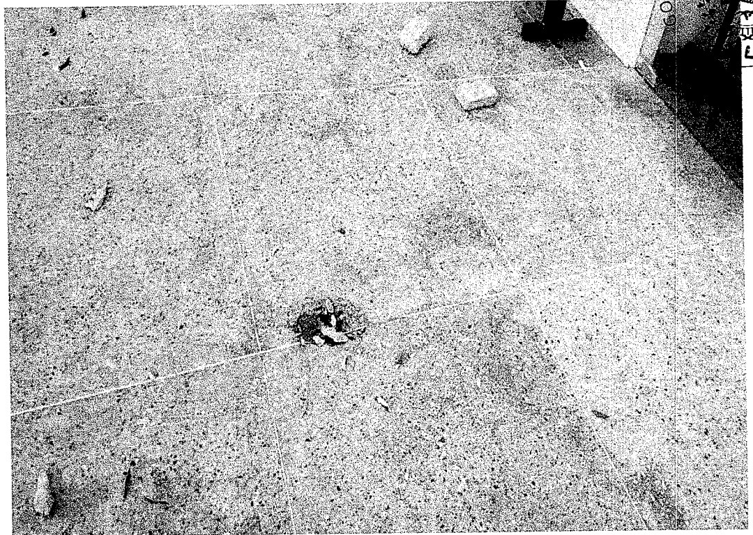
FIGURA 08: PISO CIMENTADO COM DEFEITO
