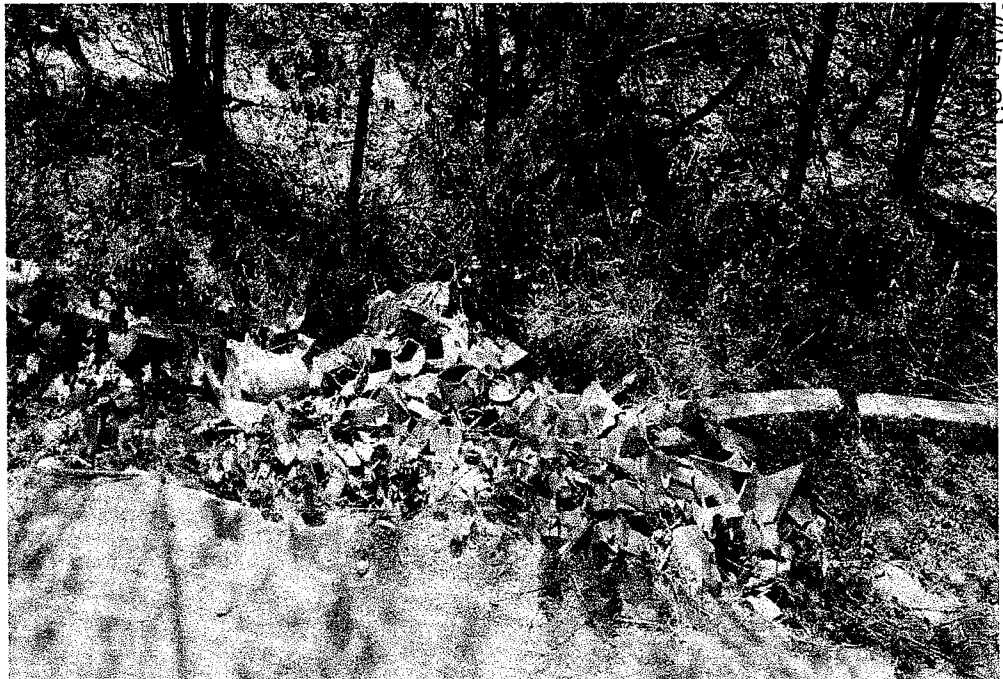
FIGURA 18: PAVIMENTAÇÃO AVENIDA ALTO ALEGRE COM DEFEITO
