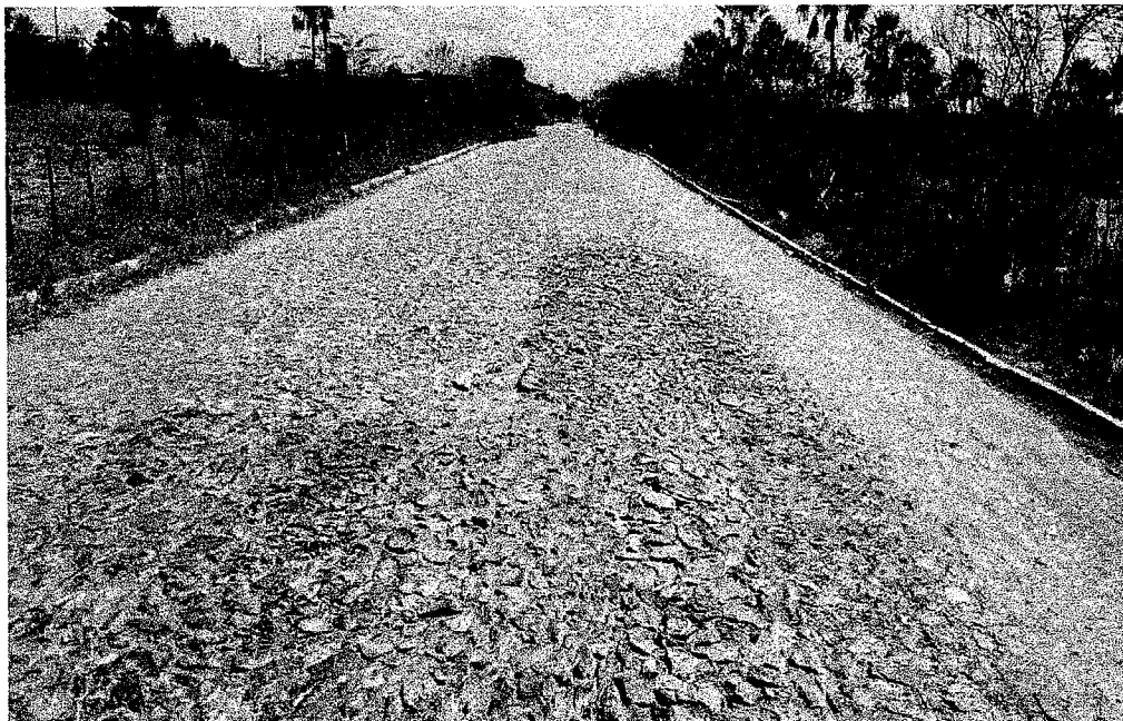
FIGURA 11: PAVIMENTAÇÃO AVENIDA ALTO ALEGRE COM DEFEITO
