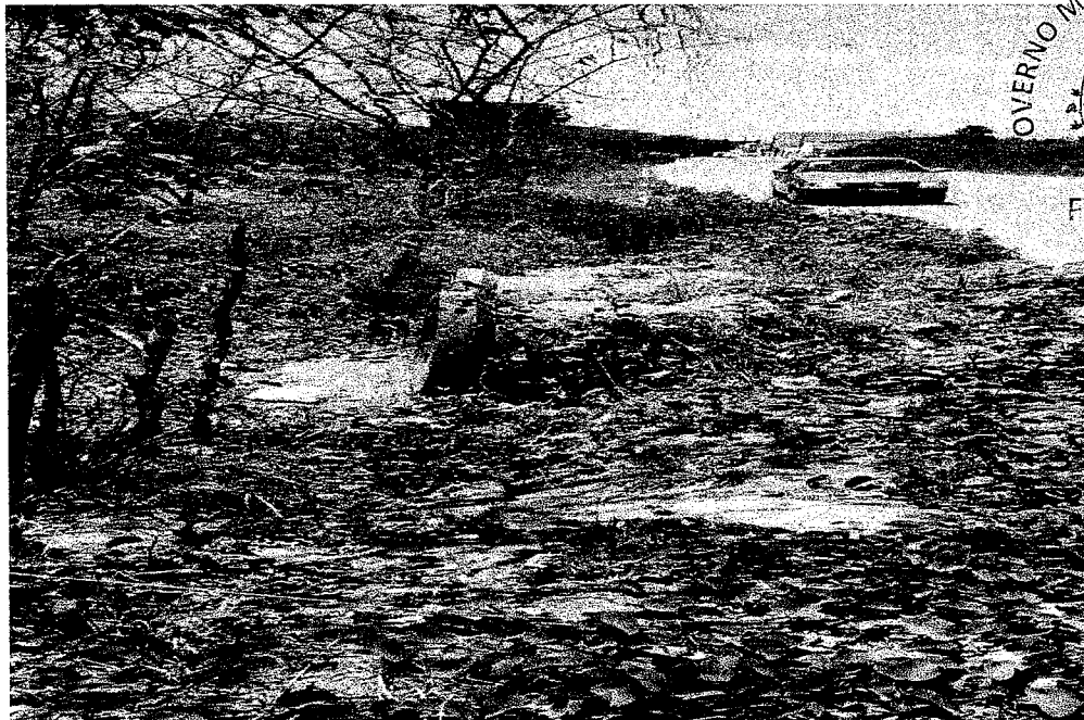
FIGURA 05: BUEIRO DA AVENIDA ALTO ALEGRE COM DEFEITO
