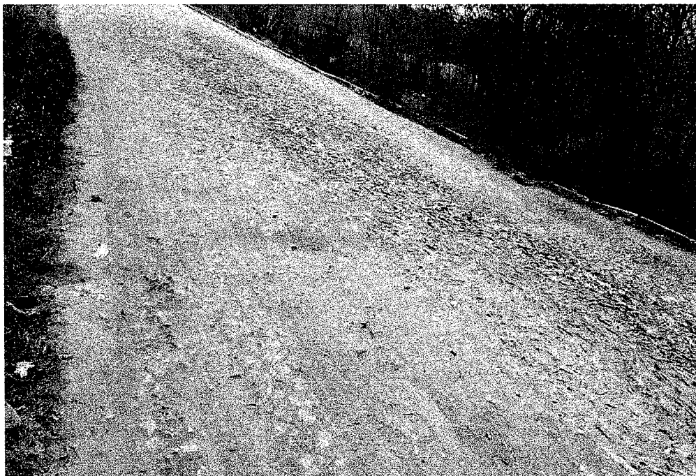
FIGURA 12: PAVIMENTAÇÃO AVENIDA ALTO ALEGRE COM DEFEITO
