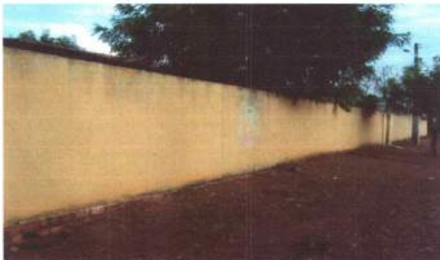
FIGURA 01: PINTURA DO MURO COM DEFEITO
