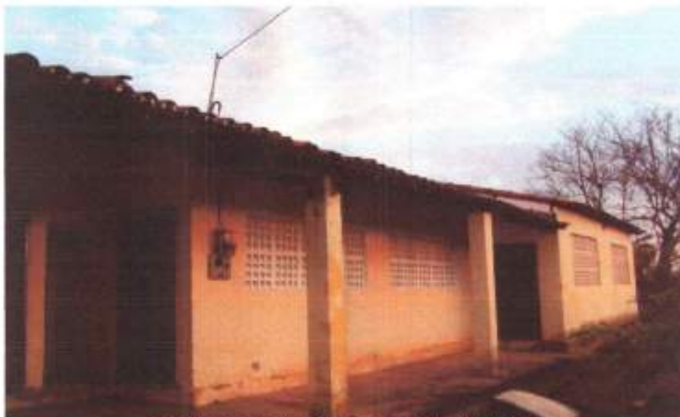
FIGURA 09: TELHADO COM DEFEITO
