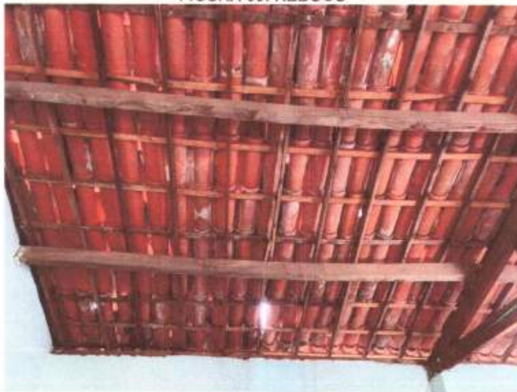
FIGURA 10: TELHADO COM DEFEITO
