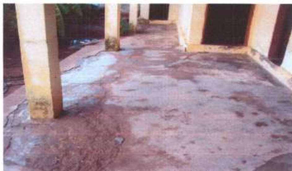
FIGURA 07: PISO COM DEFEITO
