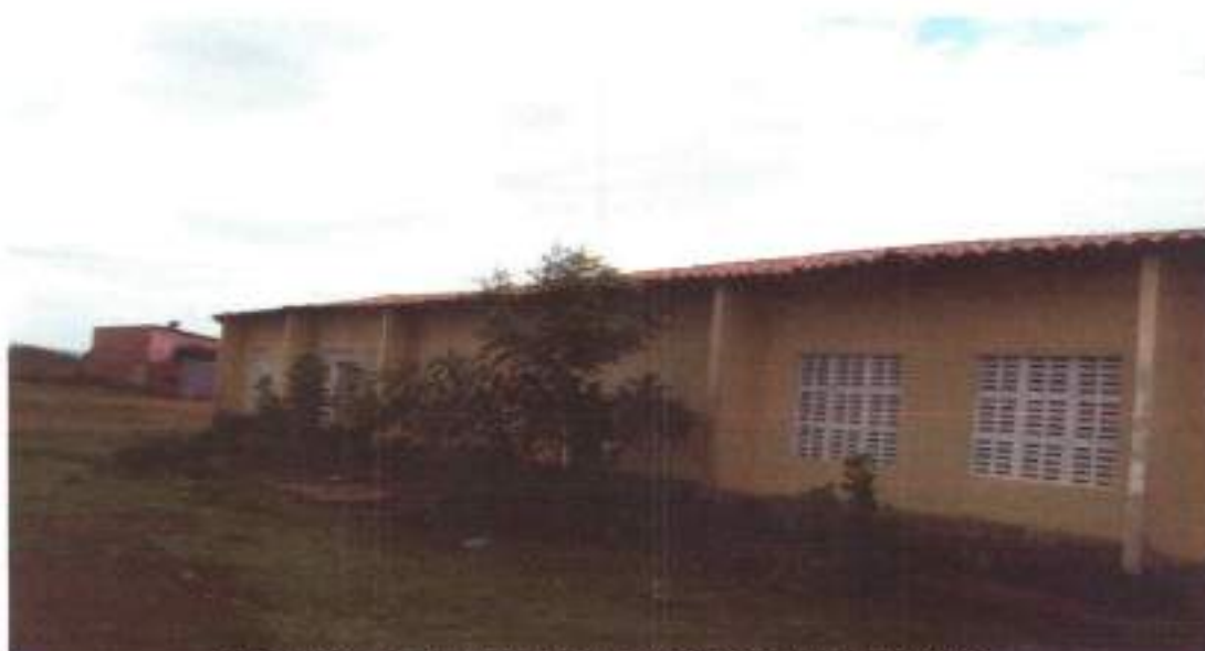
FIGURA 16: PINTURA E TETO COM DEFEITO
