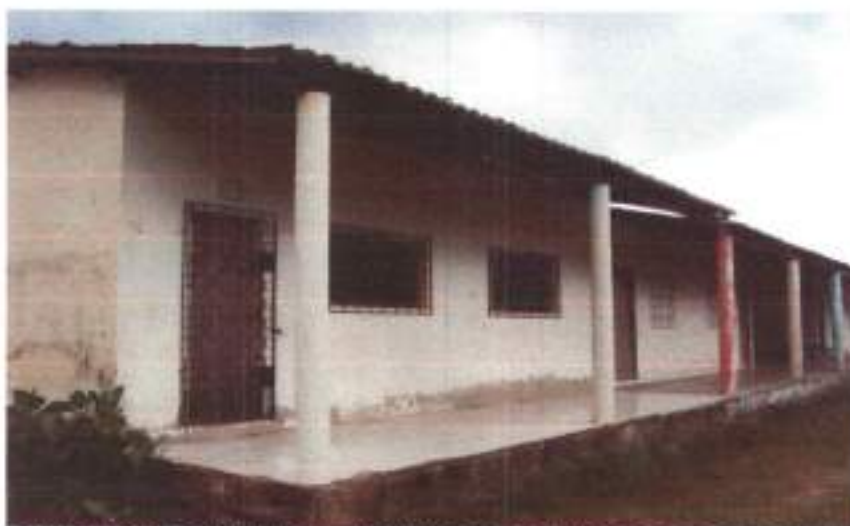
FIGURA 02: PORTAS E JANELAS DE VIDRO COM DEFEITO
