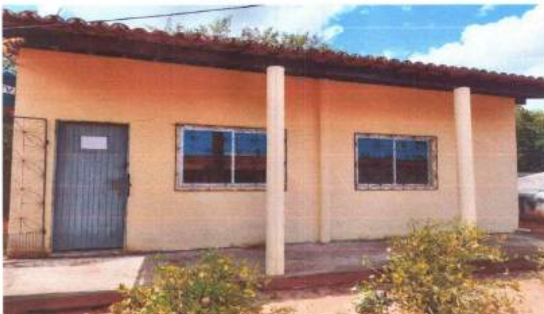
FIGURA 13: PAREDE COM DEFEITO
