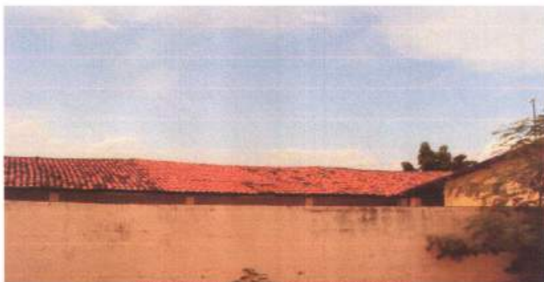
FIGURA 04: TELHADO COM DEFEITO
