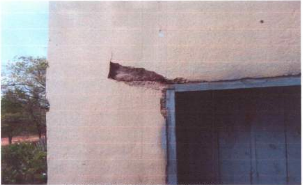
FIGURA 07: RACHADURA NA PAREDE
