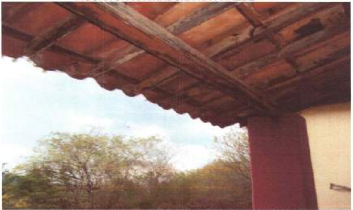
FIGURA 08: VIGA DE MADEIRA COM DEFEITO E CUPIM
