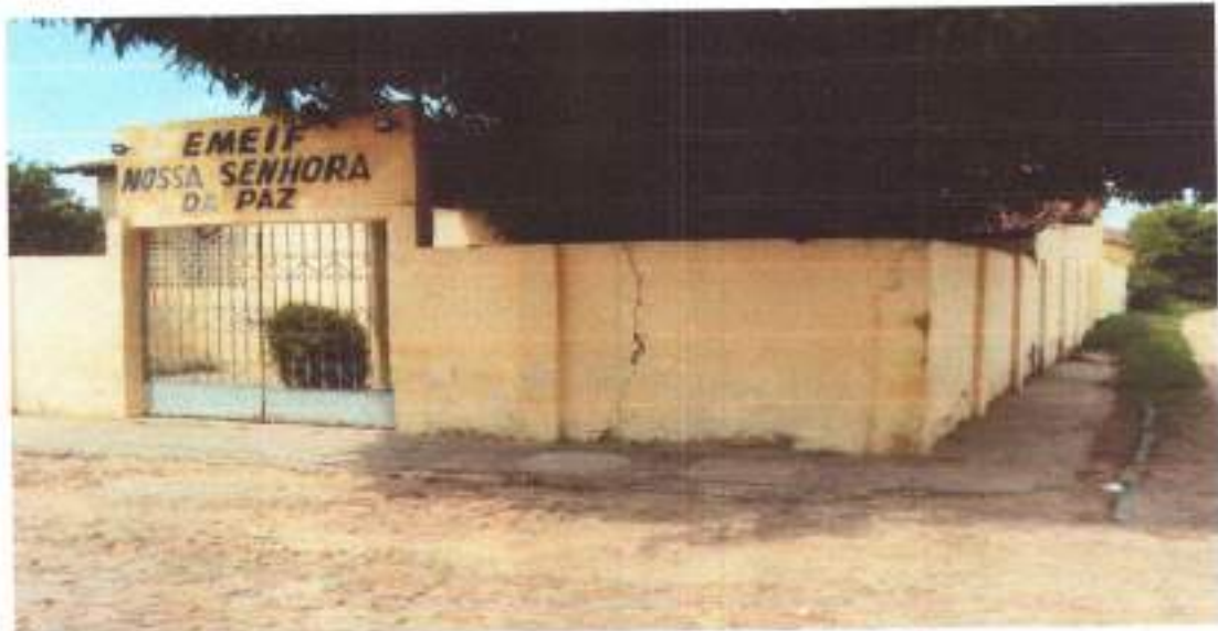
FIGURA 01: MURO COM RACHADURA
