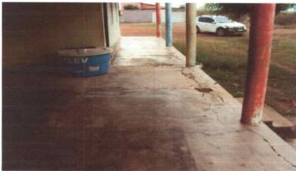
FIGURA 05: REBOCO E PISO COM DEFEITO
