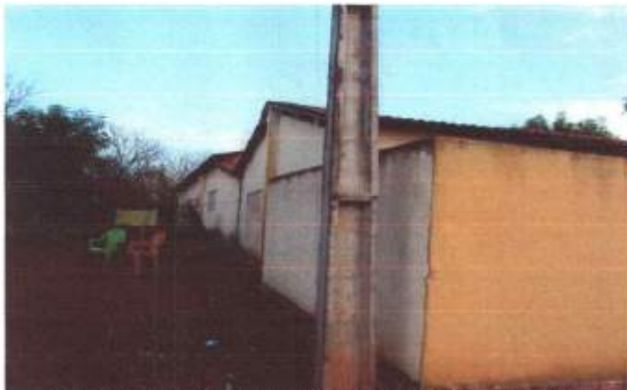
FIGURA 02: PINTURA DA LATERAL COM DEFEITO
