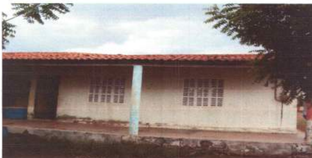
FIGURA 14: TELHADO COM DEFEITO
