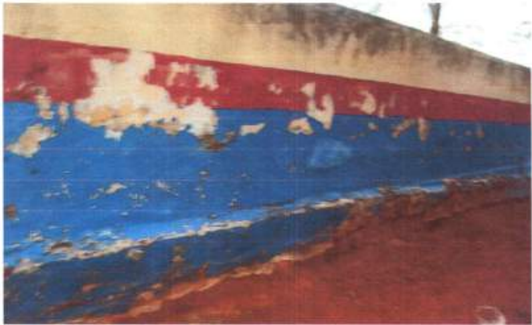
FIGURA 03: FUNDAÇÃO DO MURO COM DEFEITO
