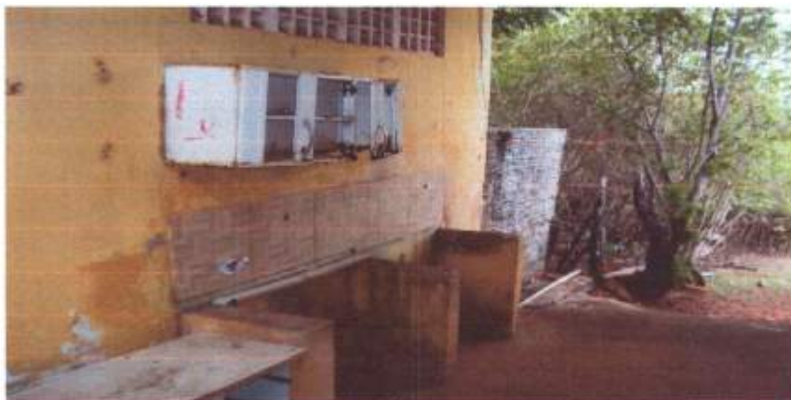
FIGURA 14: AUSENCIA DE PIA NA ÁREA DE SERVIÇOS E REBOCO COM DEFEITO
