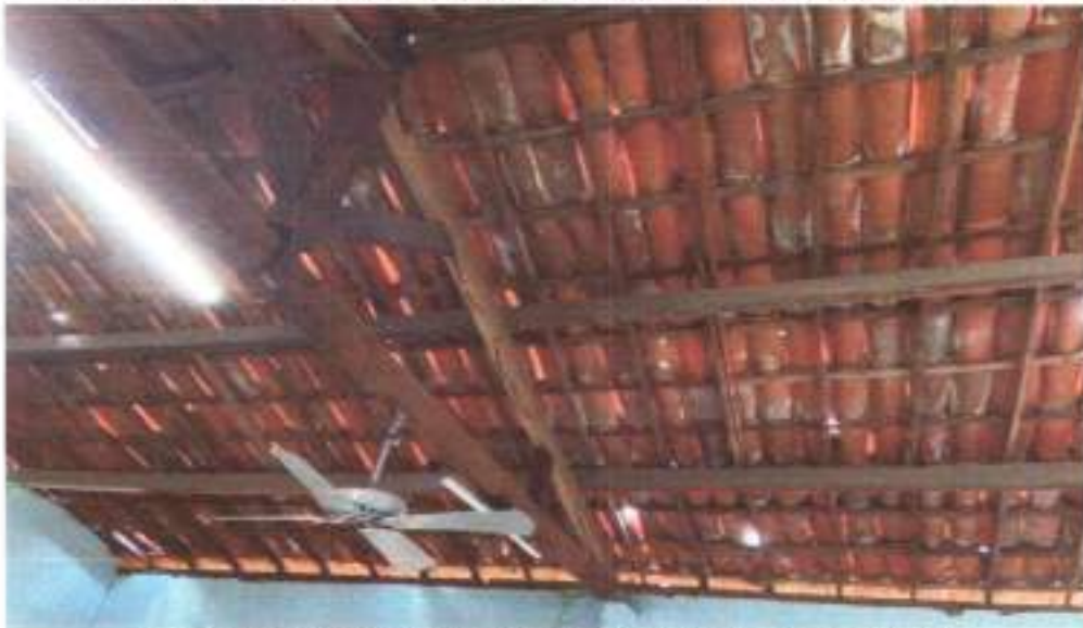
FIGURA 12: TELHADO COM DEFEITO E UMIDADE
