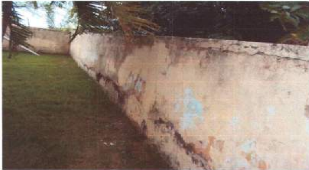
FIGURA 04: REBOCO COM DEFEITO
