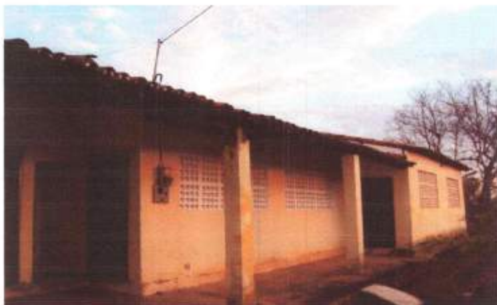
FIGURA 09: TELHADO COM DEFEITO
