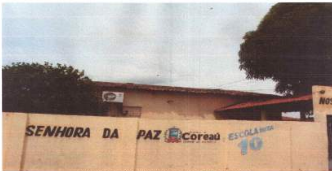
FIGURA 03: PINTURA COM DEFEITO
