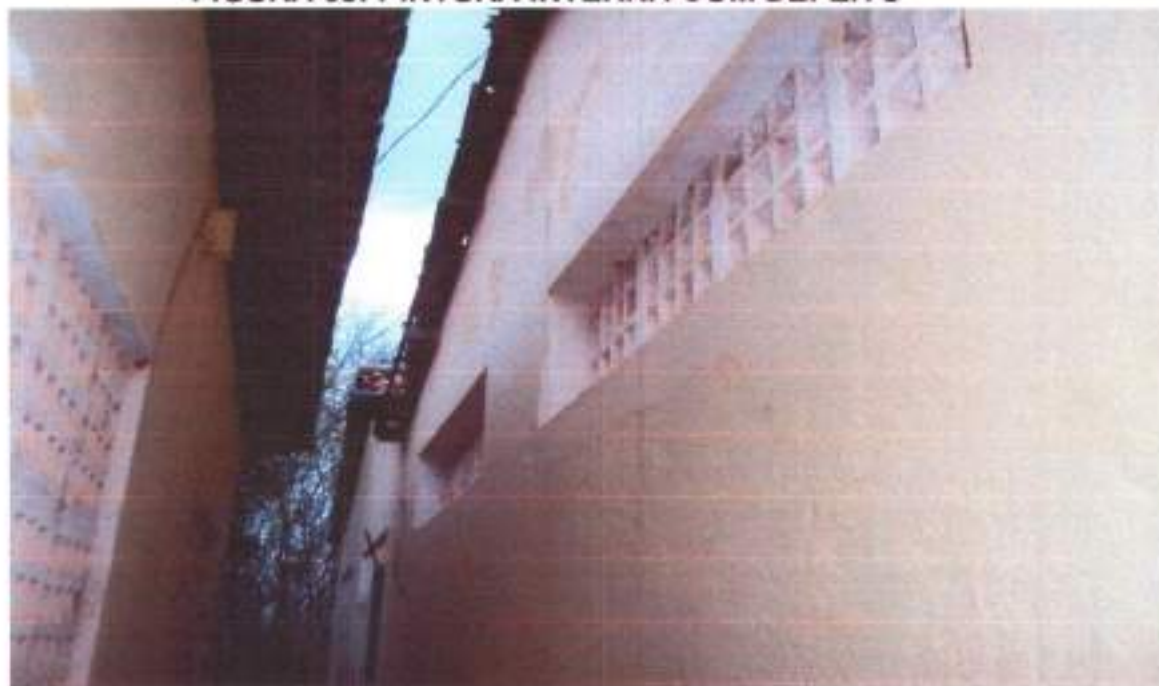
FIGURA 06: PINTURA PAREDES EXTERNAS COM DEFEITO
