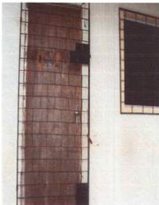
FIGURA 01: PORTA DE MADEIRA COM DEFEITO
