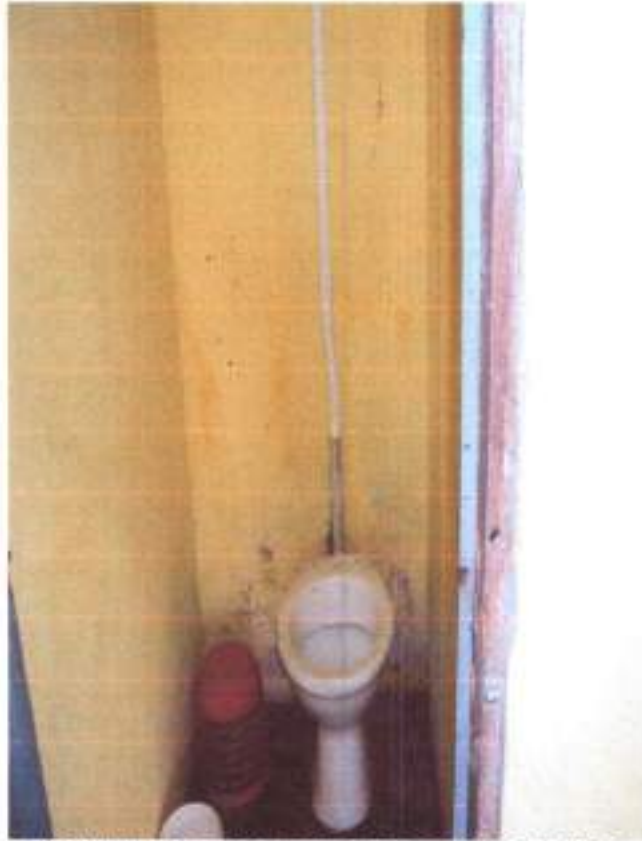
FIGURA 07: DESCARGA COM DEFEITO
