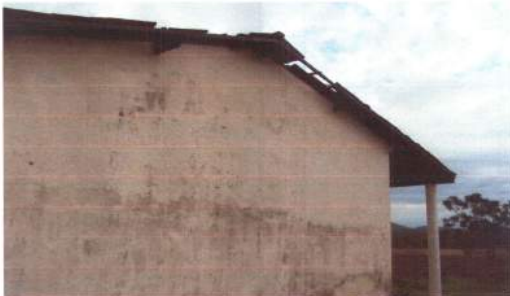
FIGURA 15: PINTURA E TETO COM DEFEITO
