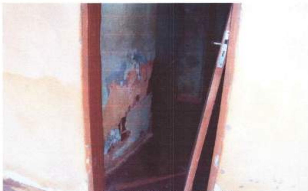
FIGURA 11: REBOCO COM DEFEITO
