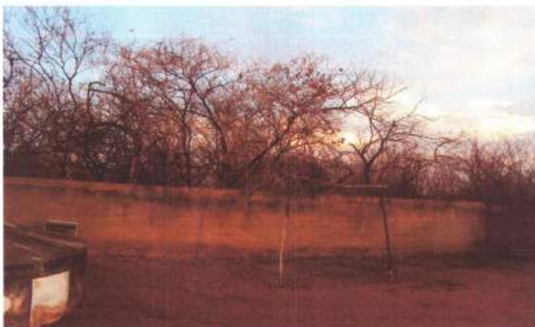
FIGURA 12: PINTURA COM DEFEITO
