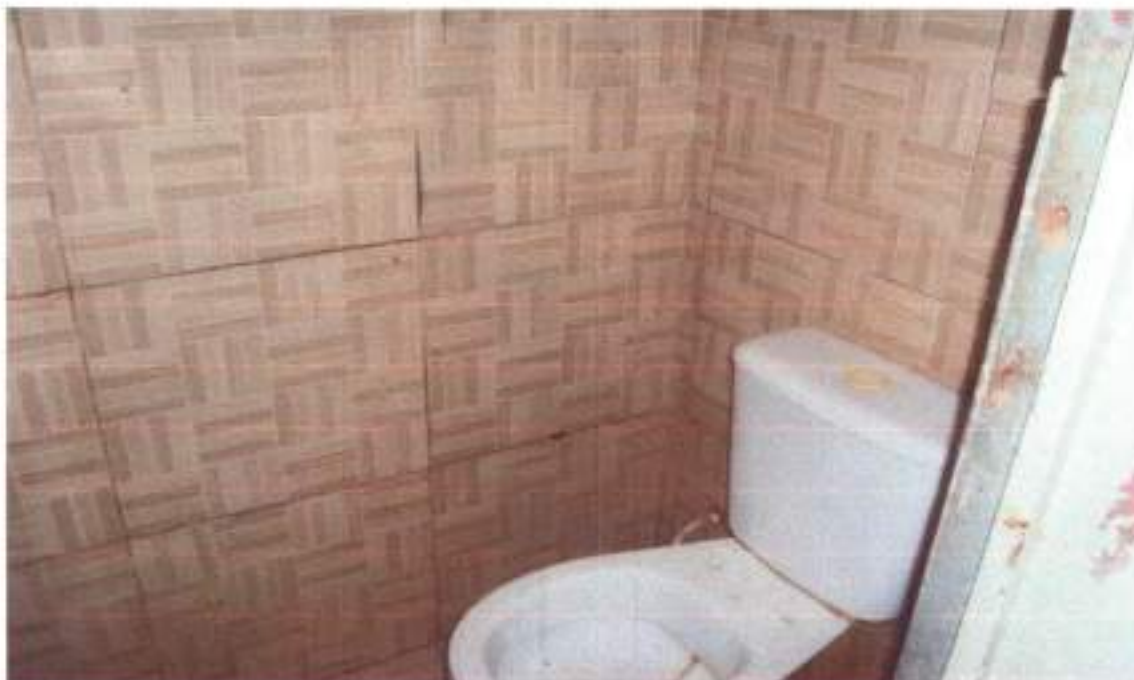
FIGURA 13: BANHEIRO COM VASO DEFEITUOSO
