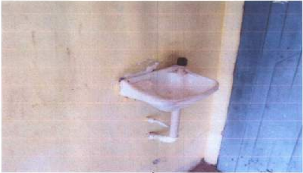
FIGURA 06: LAVATÓRIO COM DEFEITO
