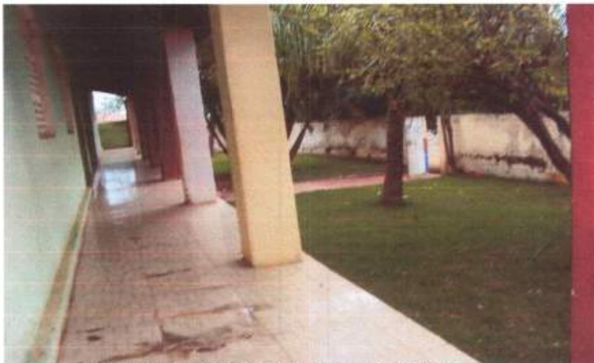
FIGURA 05: PINTURA INTERNA COM DEFEITO
