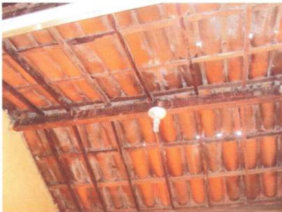
FIGURA 15: INSTALAÇÃO ELÉTRICA COM DEFEITO
