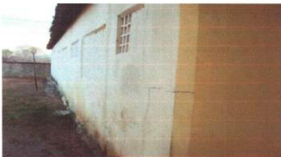
FIGURA 05: RACHADURA NA PAREDE
