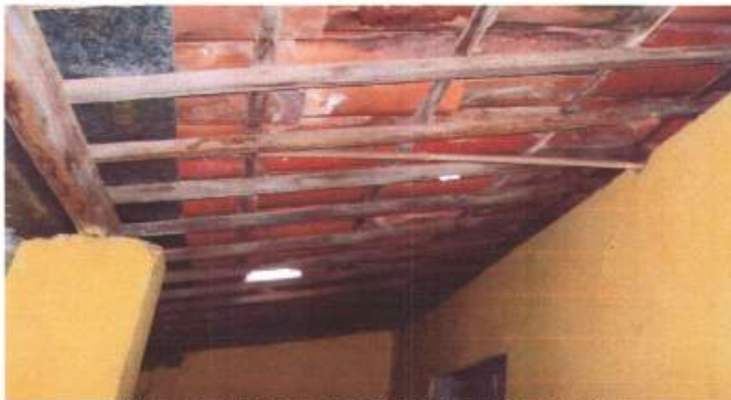
FIGURA 11: TELHADO COM DEFEITO E CUPIM
