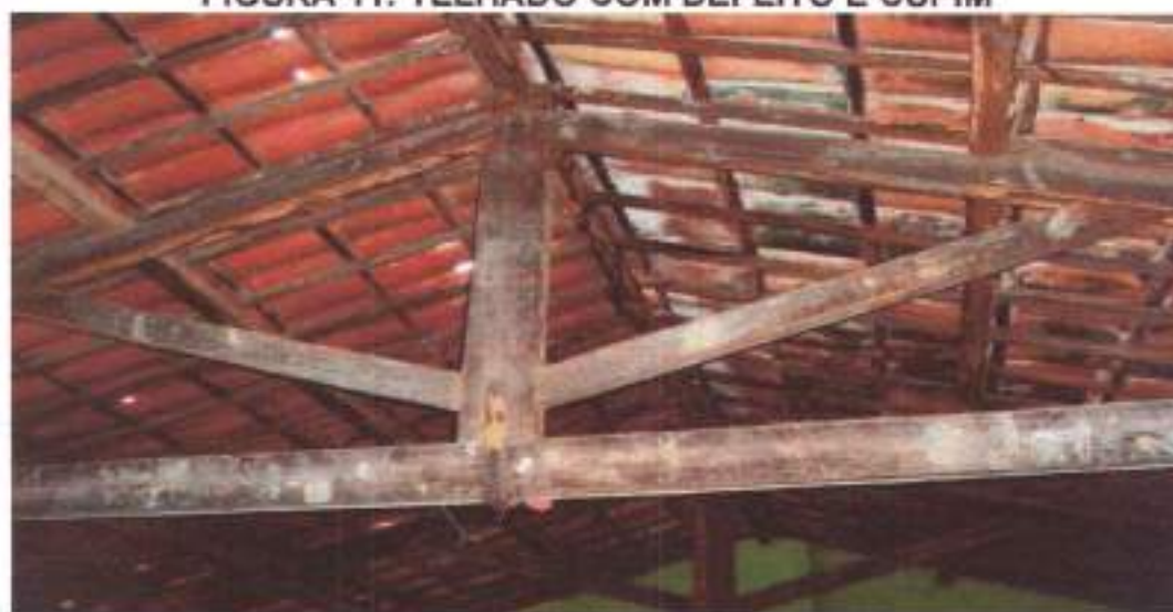
FIGURA 12: TELHADO COM DEFEITO E CUPIM
