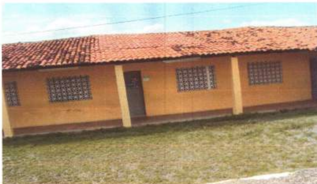
FIGURA 06: PINTURA COM DEFEITO
