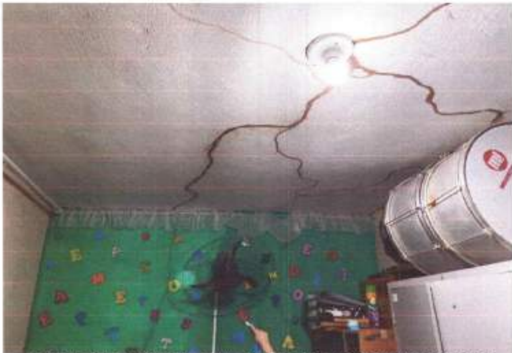
FIGURA 11: PINTURA COM DE FEITO E FORRO COM CUPIM
