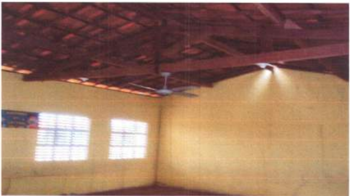
FIGURA 11: TESOURA DE MADEIRA COM DEFEITO
