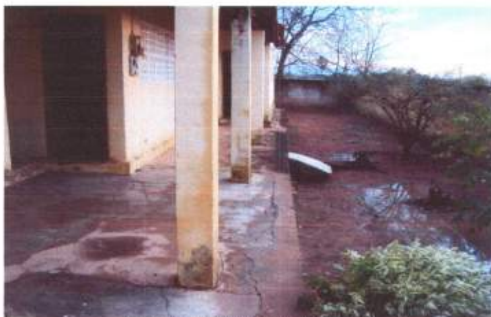
FIGURA 08: PISO COM DEFEITO
