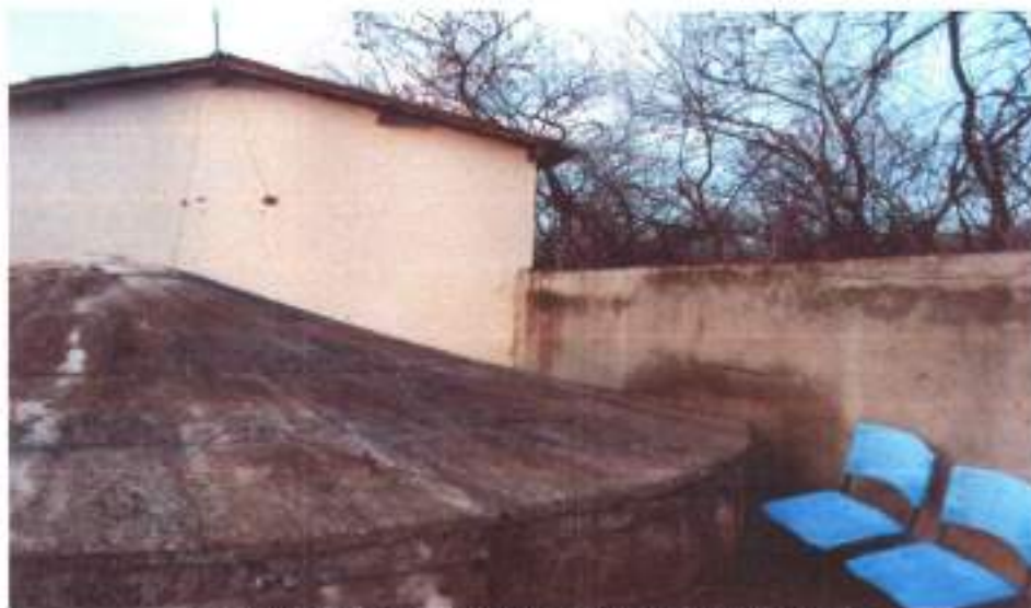
FIGURA 06: RACHADURA NA PAREDE
