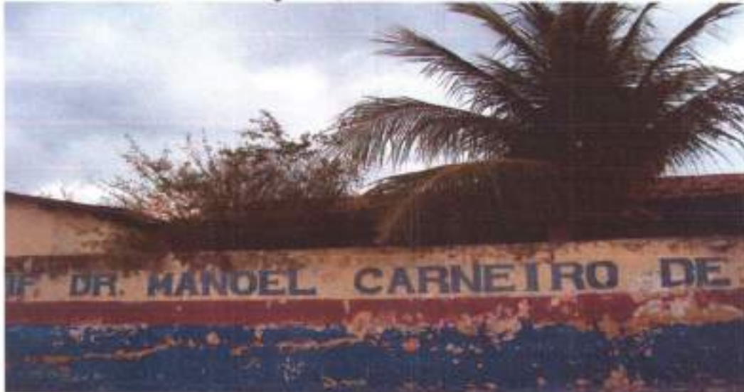
FIGURA 01: REBOCO E PINTURA DO MURO COM DEFEITO
