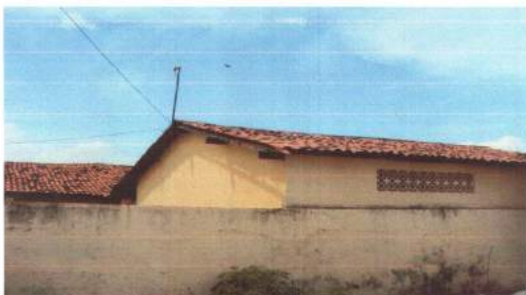
FIGURA 05: TELHADO COM DEFEITO
