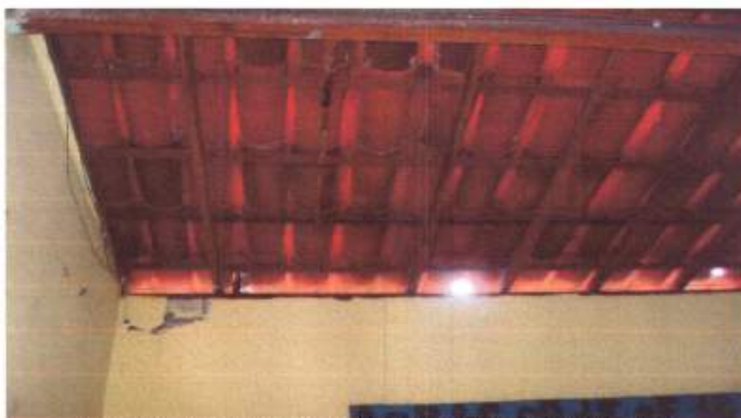
FIGURA 13: MADEIRAMENTO DO TETO COM DEFEITO
