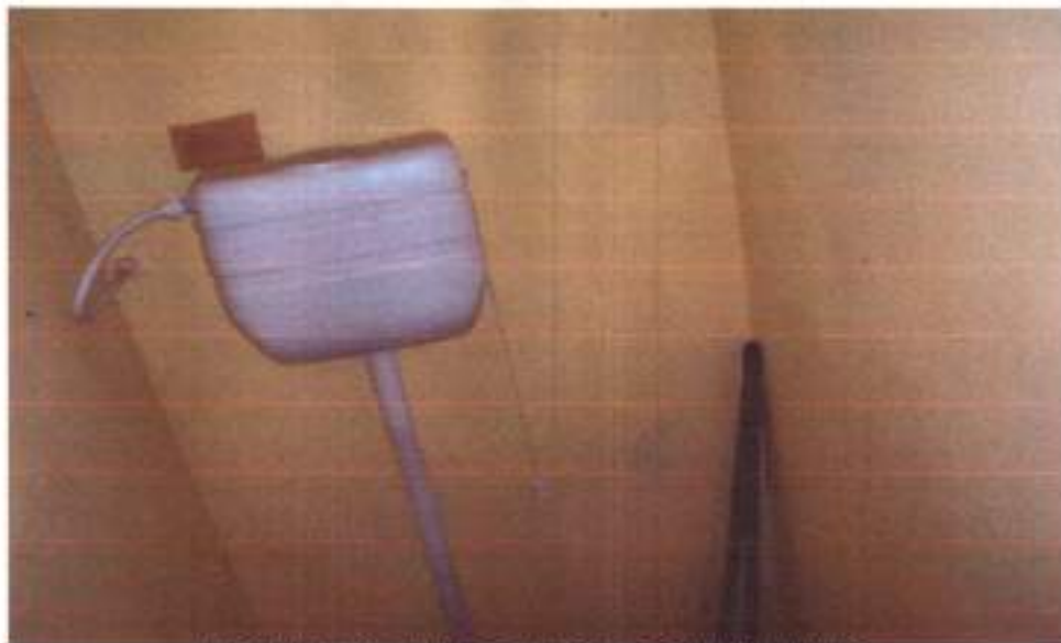
FIGURA 08: DESCARGA COM DEFEITO
