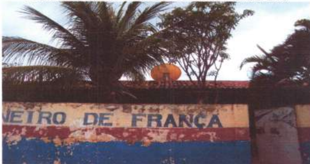
FIGURA 02: REBOCO E PINTURA DO MURO COM DEFEITO
