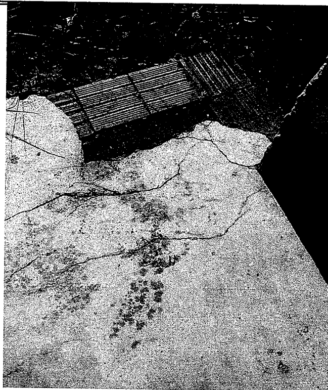
Foto 06- Vista de pisos defeituosos, onde deverão ser trocados
